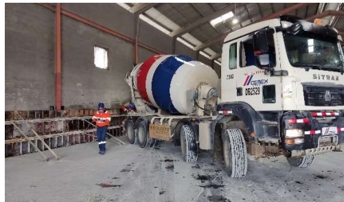
“Construcción de Muro de reforzamiento en galera de envase de la planta de cemento Bayano en Calzada Larga -120 m”
